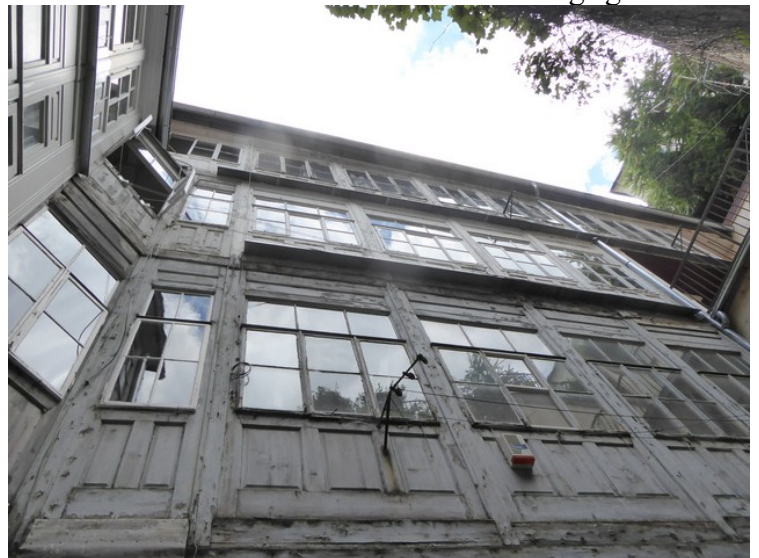
Denne inngangen ligger i et gårdsrom til en bygning med veldig slitt trefasade.
