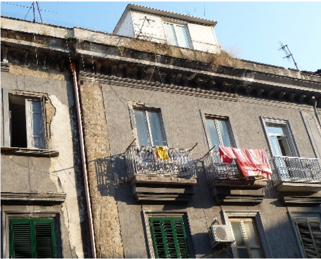
Murpussen flasser av og det vokser ugress i takrennene
