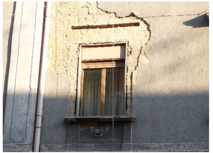
Fasadene var ikke mye vedlikeholdt
