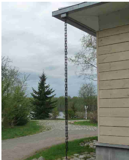
Nedføring fra takrenna.
