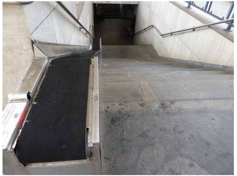
Dette er et transportbånd for tung bagasje. Istedet for å slepe bagasjen opp trappene settes bagasjen på båndet og det begynner å gå. Lettvint!
