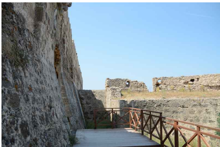
Det er bygget terrasser for at det skal være lettere å gå for turistene.
