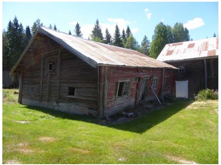
Dette huset trenger å støttes opp så det ikke faller sammen.
