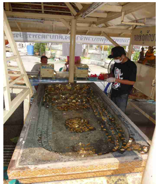
Dette er en utsmykning som repareres. Det mangler noe bladgull her og der.
