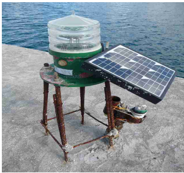
Det står en fyrlykt helt ytterst som er drevet av solcellepaneler
